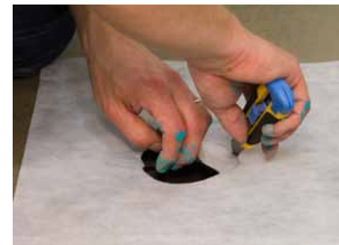
17. Kaivolaippaan leikataan kaivonvalmistajan ohjeiden mukainen reikä ja kiristysrenkas painetaan paikoilleen. Kiristysrenkaan alareunan ja kaivon liitoskohta tiivistetään KiiltoFix Masa liima- ja tiivistemassalla.
