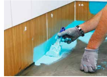
14. Vedeneriste nostetaan seinäpinnalle n. 100 mm, kuitenkin niin, että vedeneristys ja Nurkkavahvikenauha nousevat vähintään 30 mm peltikasetin reunan yli.
